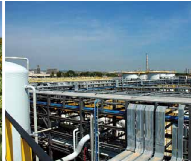
| impianto di Trattamento Acque di Falda (TAF)
