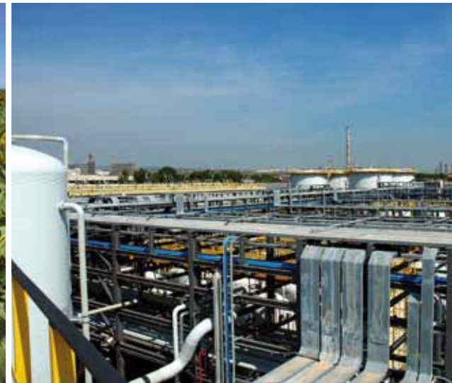
| impianto di Trattamento Acque di Falda (TAF)
